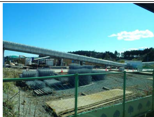
写真④-6 土壌運搬用ベルトコンベア
