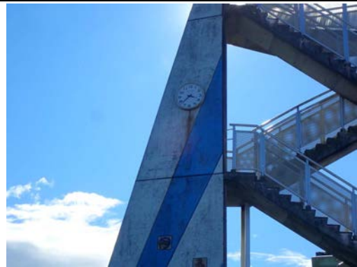
写真②-2 津波被害時刻で止まっている時計
